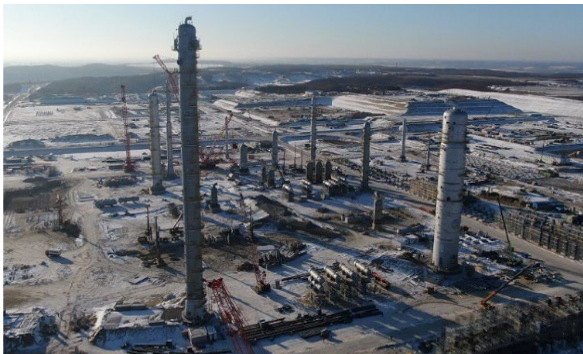
アムール州で建設中のアムール・ガス化学プラント(2021年12月現在、AGCCホームページ)
