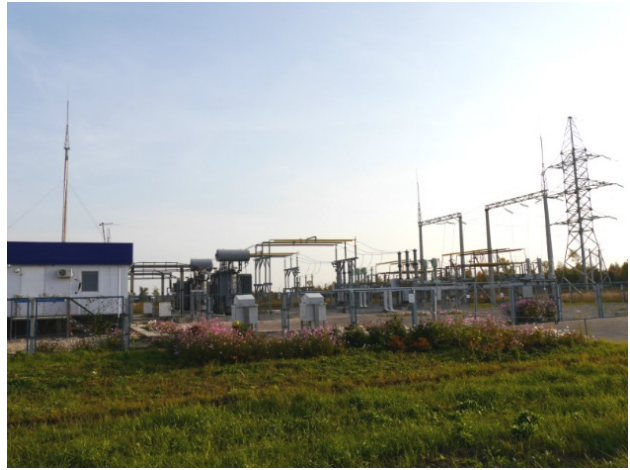
ザヴォルジエ工業団地の変電所 グリーンフィールドとは言え、すぐに接続可能なインフラが準備されている。
